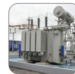
Объекты энергетической отрасли
